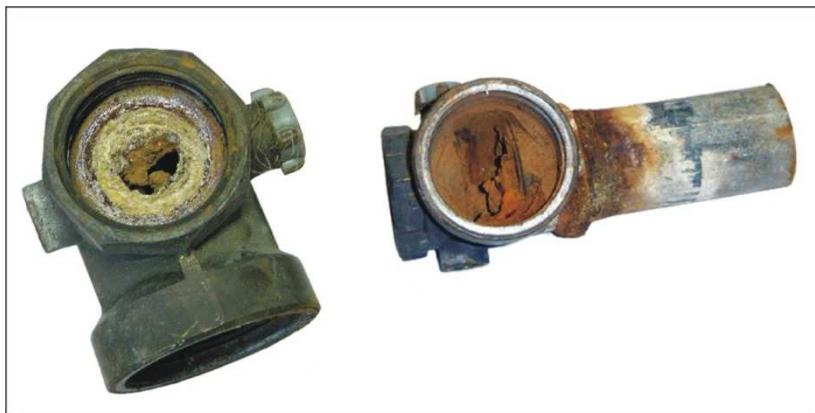
Reduzierung der Durchlassnennweite durch Steinbildung an einem verzinkten Stahlrohr
