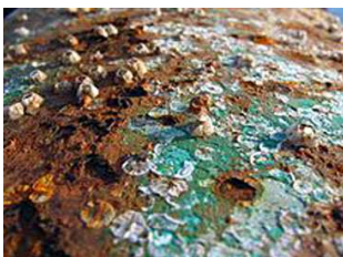
Rostbildung an Rohren durch Sauerstoffkorrosion
