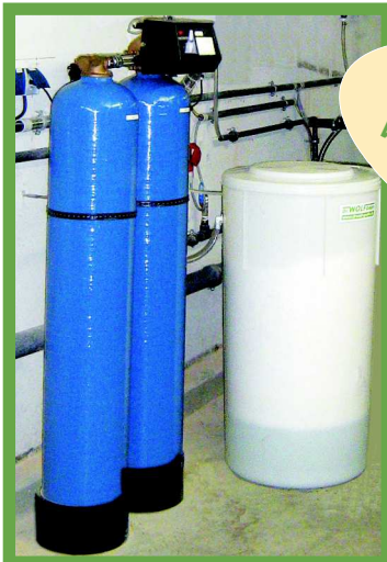
Doppelenthärtungsanlage zur Aufbereitung von Produktwasser
